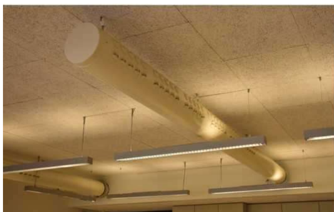
Mechaniczna wentylacja w sali lekcyjnej
